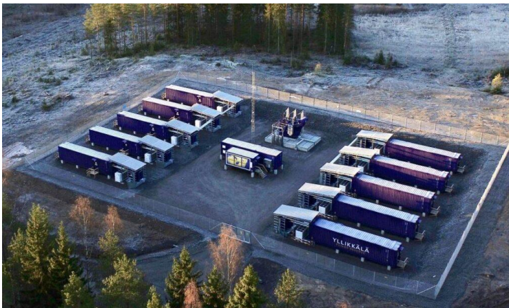
Kuva 7.2. Esimerkkinä Neoenin Yllikkälän akkuvarasto (30 MW) Lappeenrannassa.
